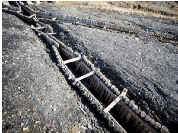
Overvannsrenner i Pyramiden
