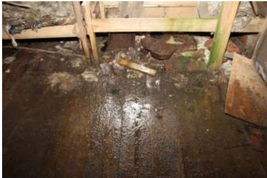
2365: Lekkasje i taket fører til store våte områder i hovedstasjonen—her i mannskapsrommet.
