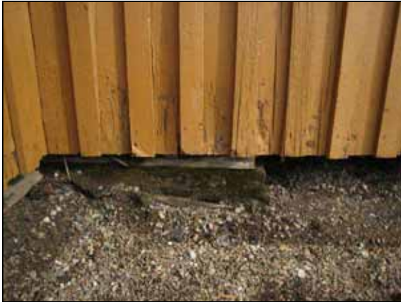
London 1. Råteskader i nedre del av panel, terrenget har ligget for høyt.
