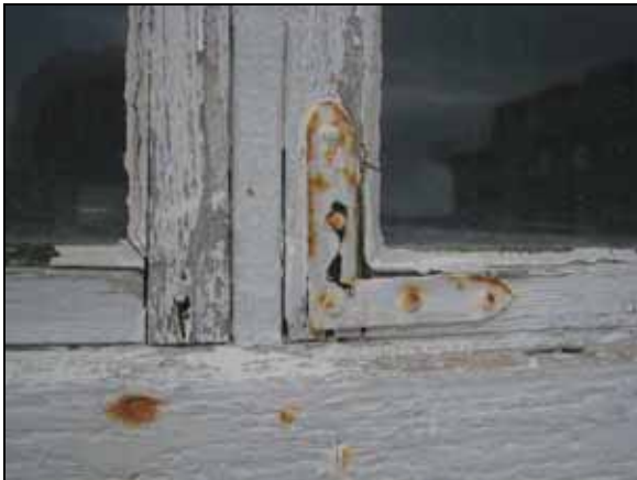
Gamle telegrafan. Rust og løse stifter tyder på råteskader bak beslag. Behov for vedlikehold av maling og kitt.
