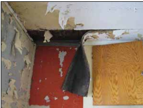
Gamle telegrafan. Sterkt skadet platekledning i tak, omfattende avflissing. Flere plater må skiftes.
