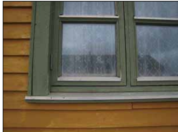
Amundsenvillaen. Nytt vindu med for grove dimensjoner, glass uten kitt og med aluminiumsbeslag. Begge foto: Siri Hoem, Sysselmannen 2008.
