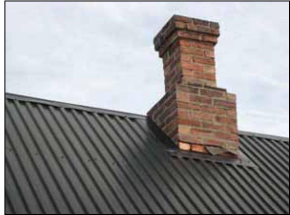
London. Frostsprengt tegl ved beslag. Begge foto: Siri Hoem, Sysselmannen 2008.
