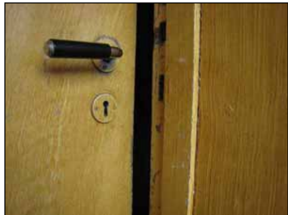
London 2. Ådring bør konserveres/avdekkes/gjenskapes. Begge foto: Siri Hoem, Sysselmannen 2008.
