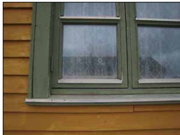
Amundsenvillaen. Nytt vindu med for grove dimensjoner, glass uten kitt og med aluminiumsbeslag. Begge foto: Siri Hoem, Sysselmannen 2008.
