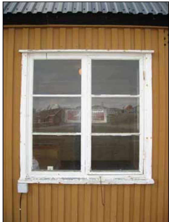
London 1. To-fags vindu med midtpost, tre ruter i hver ramme. Malingslitt, men godt vindu. Foto: Siri Hoem, Syssemmannen 2007.
