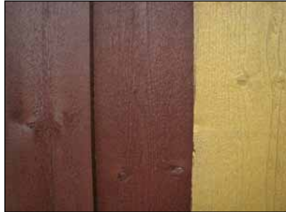
Nordpolhotellet. Ny panel med uhøvlet, bustete overflate. Begge foto: Siri Hoem, Sysselmannen 2008.
