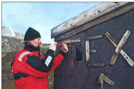
Kulturminnerådgiver Hans Olav Stegarud gjennomfører reparasjoner på fangsthytta Texas Bar. Foto: Tone Hertzberg/Sysselmannen på Svalbard.
